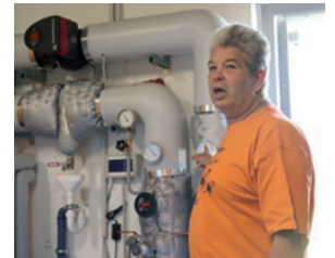
Borstel-Hohenraden nutzt in Kooperation mit einem Landwirt Energie aus Rinderdung für die Wärmeversorgung. Im Heizhaus der Gemeinde wird überschüssige Wärme aus Biogas, das der Landwirt aus den Fäkalien seiner 250 Milchkühe gewinnt, gespeichert und ins Nahwärmenetz eingespeist, so Bürgermeister Harm Kähler (FWG).
